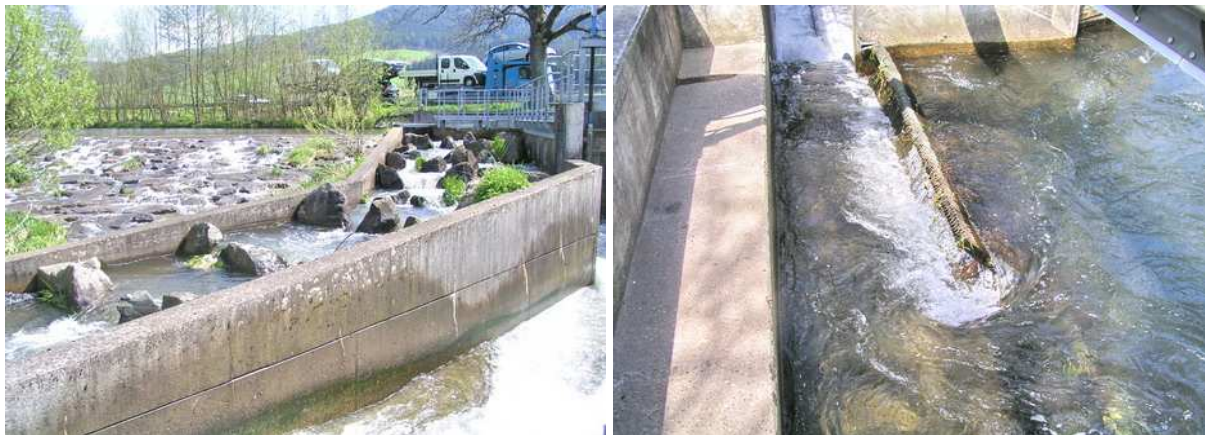
Wehr des Wasserkraftwerks der Wasserkraft Volk an der Elz/ Kreis Emmendingen li.: rauhe Rampe (links im Hintergrund) und Fischaufstieg (Bildmitte); re.: Rechen: Bildmitte, mit Fischpass abwärts (linke Bildmitte).
